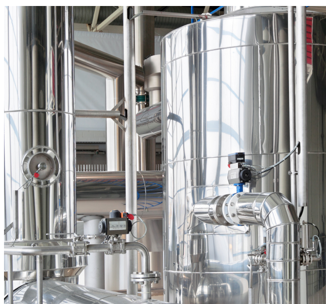
Beispiel einer typischen Wasser-Aufbereitungsanlage mit verschiedenen Rohrverbindungen, Armaturen und Ventilen.
