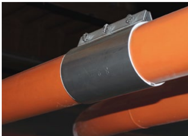
Abb: Rohrkupplung an einem Transportrohr für Mehl in einer Bäckerei
